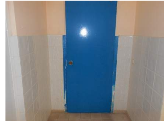
ΑΝΤΙΚΑΤΑΣΤΑΣΗ ΕΞΩΤΕΡΙΚΩΝ ΞΥΛΙΝΩΝ ΘΥΡΩΝ ΑΠΟΔΗΤΗΡΙΩΝ, ΓΡΑΦΕΙΩΝ ΚΑΙ ΧΩΡΩΝ ΥΓΙΕΙΝΗΣ ΜΕ ΝΕΕΣ ΘΥΡΕΣ ΤΥΠΟΥ PVC
